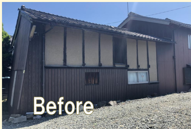
昭和初期に建てられた土壁造りの旧家は、住まい手もなくなり維持管理が難しくなってきました。
