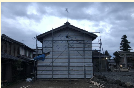
建屋の解体が終わると、母屋との取り合い部の壁を仕上げていきます。
