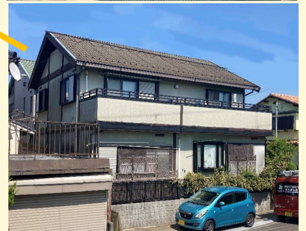
経年劣化が気になっていました。
