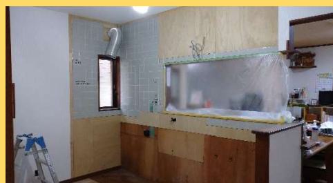
既存のキッチンを解体し、配管や配線を仕込み直し、新しいキッチン取付準備を行います。
