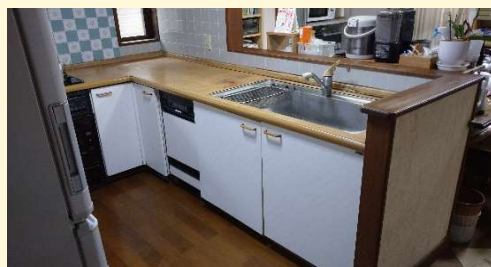
新築時の海外製のキッチンを大切に使用しておられましたが、水漏れにお悩みでした。
