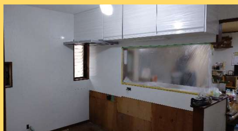
タカラスタンダードのメーカー施工でのキッチン設置工事です。
