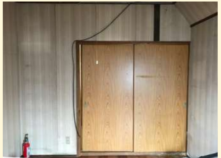
壁の汚れも気になっていました
